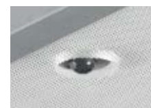
Tageslicht- und Anwesenheitssensor Daylight- and movement sensor
